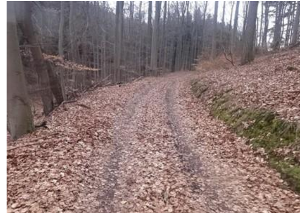
Abbildung 8: schlechte Belagsqualität auf dem beschilderten Weg zwischen Bachem und Ramersbach
