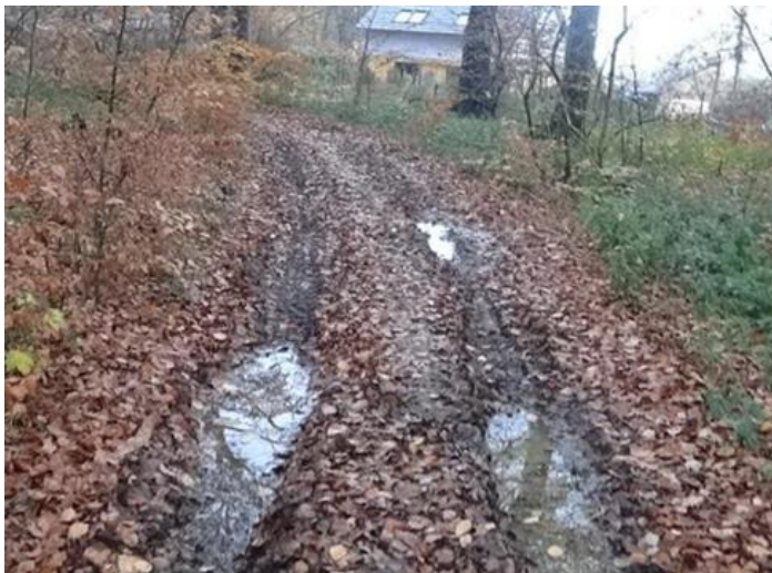
Abbildung 11: Unbefahrbare Belagsqualität auf der Alternativroute zwischen Bachem und Ramersbach
